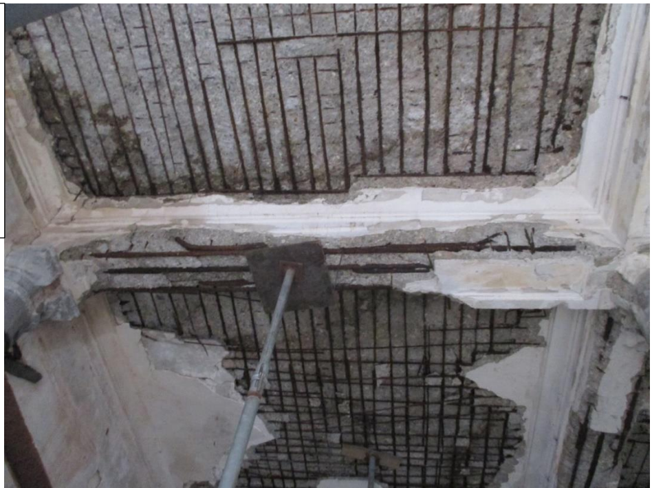
西市場本館-中央棟一樓室內天花板修復前(20170719)
